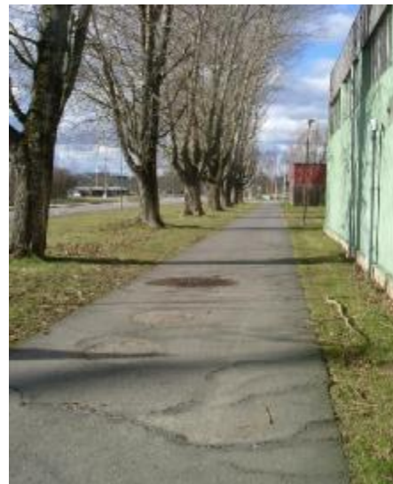
Asfalten spricker av de höga trädens rötter
